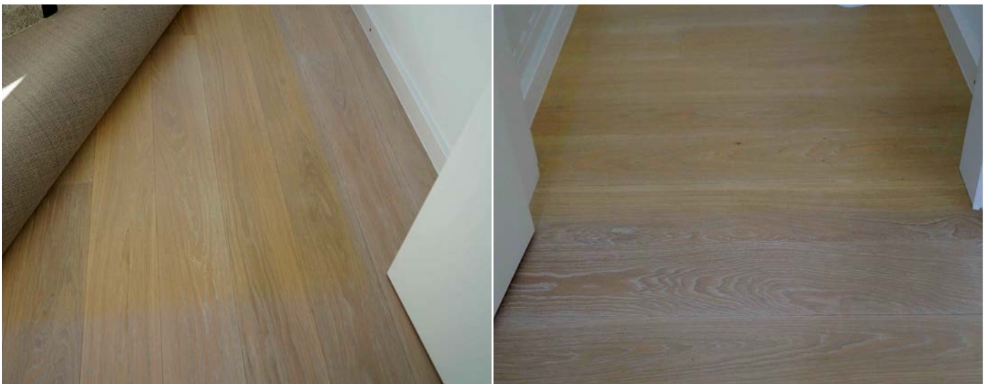
Dunkervergilbung weiß geölter Eiche-Landhausdielen: Dieser Effekt kann auftreten, wenn das Holz vom Tageslicht abgeschirmt ist.
